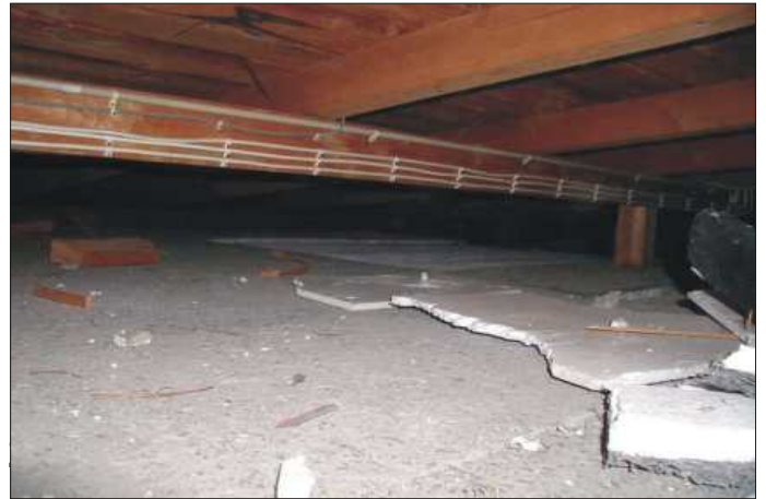
Ungenügende Dämmung im schwer zugänglichen Dachraum
